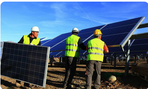
Panneaux solaires d'une centrale
